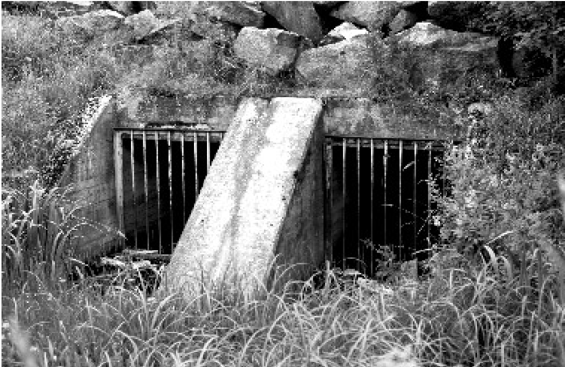
Bild 10. Gallret till kulverten under järnvägen, sett västerifrån. Gallret utgör vandringshinder för större däggdjur, och skulle kunna tas bort, om säkerheten tillåter. Fotograferad från väster (foto 1:10).
